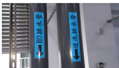
RO 及逆洗排水
