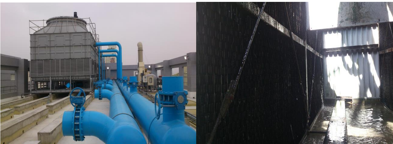
冷卻水塔散熱鰭片更換節能方案(圖八)
